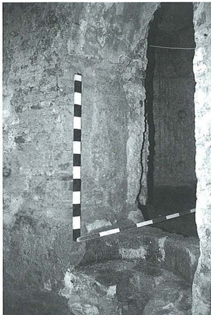
6. kép: Lukács fürdő. A kibontott 6. sz. nyílás – 19. századi ajtó vörös festett vakolattal, szegmensíves záródás vállindításával és másodlagos behelyezésű szárkővel
