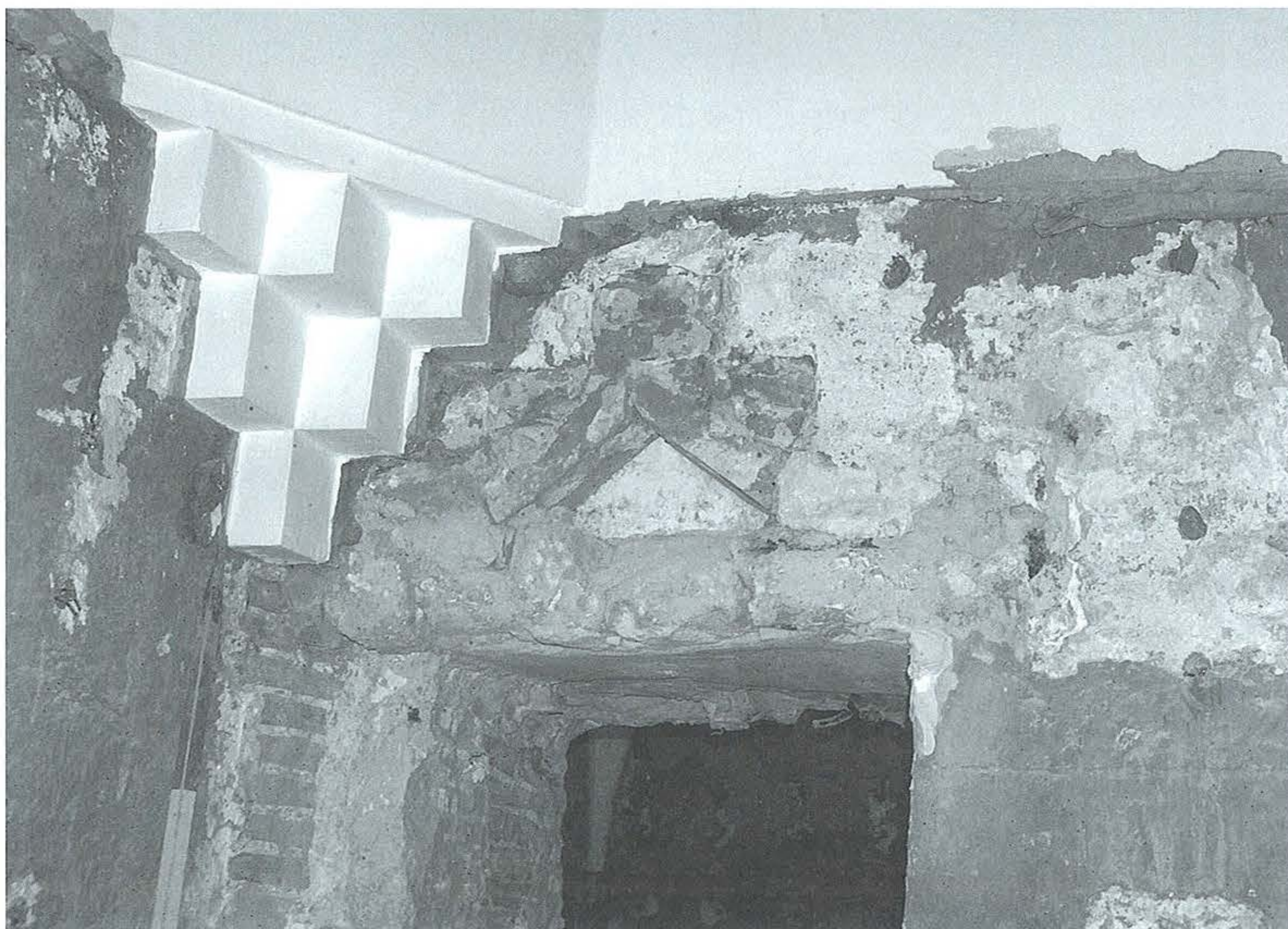
17. kép: Császár fürdő. Az ajtó felett feltárt lépcsőzetes kialakítású török faltükör és benne a barokk egyenes záródású kőkeret maradványa és az annak behelyezésekor készült téglakifalazás
