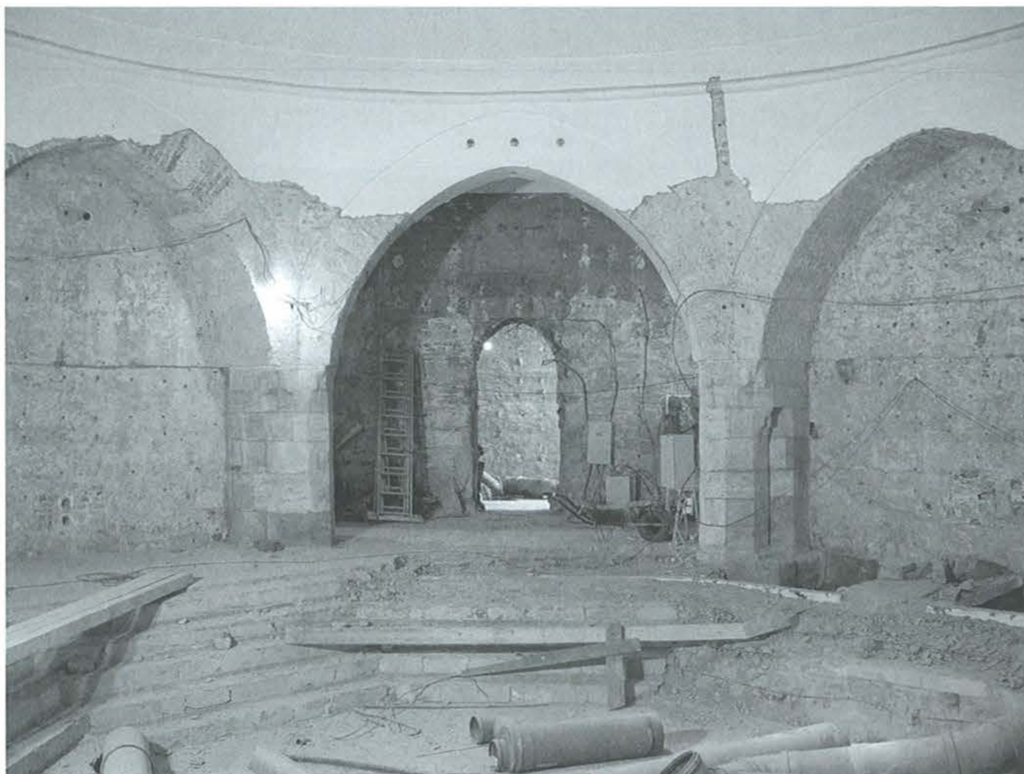
15. kép: Császár fürdő. A kupolatér keletről nézve. Jól látható, hogyan tüntette el a pillérlábazatokat az utolsó helyreállítás szintemelése.
